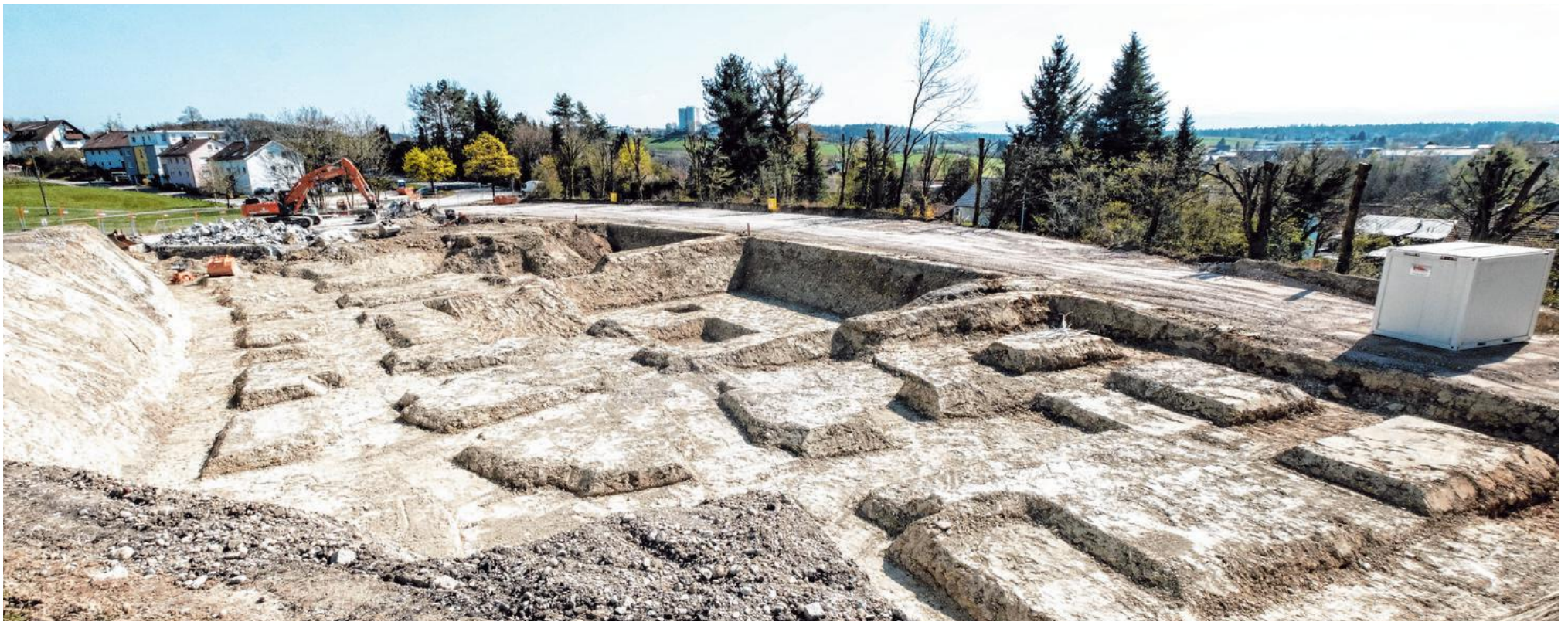
Die Tiefbauarbeiten sind weit gediehen. Die Strukturen für die späteren Bauwerke sind bereits gut zu erkennen.
